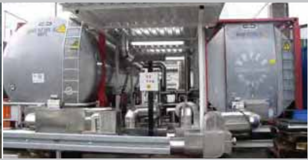
Tanklager, liegend für Polyesterpolyole horizontal tank system for polyester polyols
