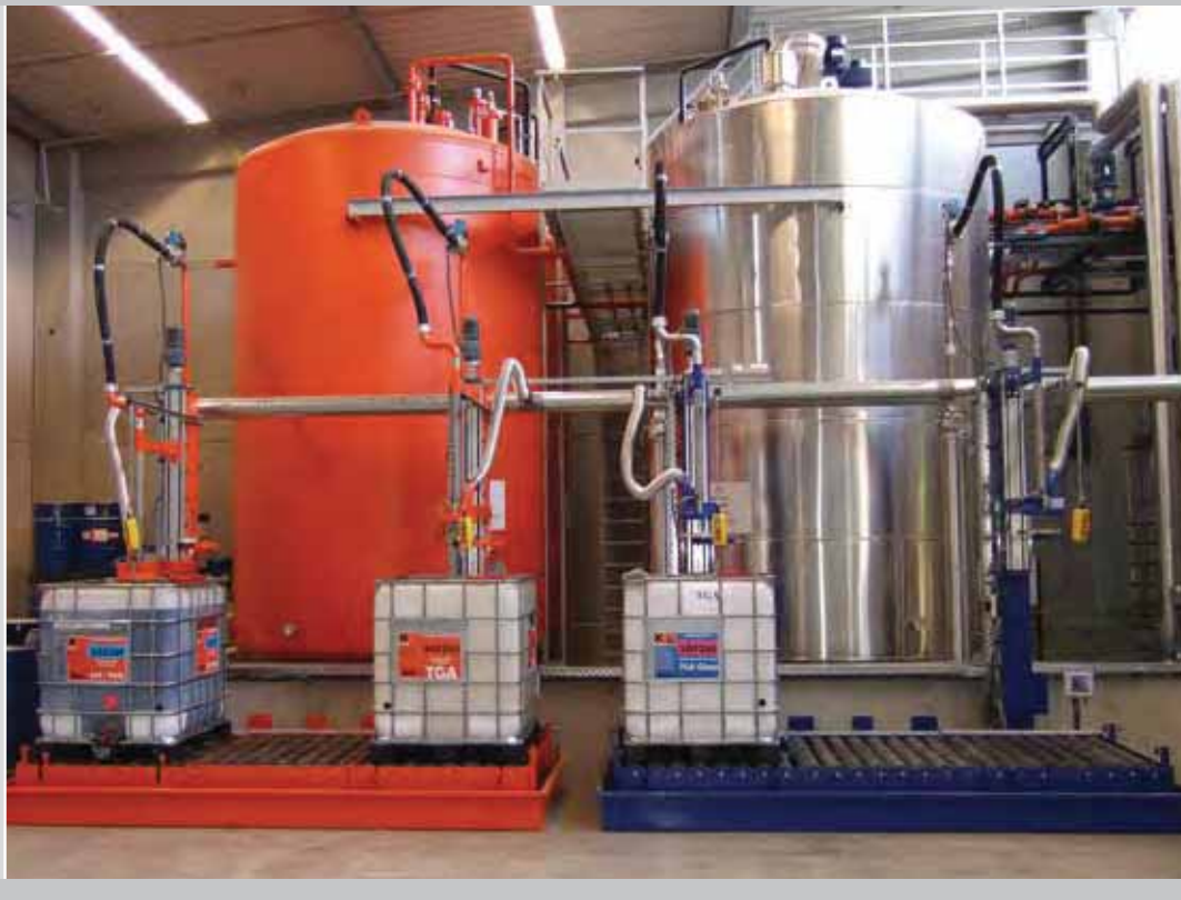
Tanklager mit Abfüllanlage tank-farm with filling station
